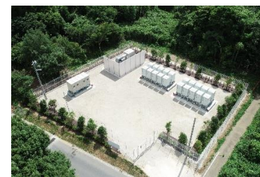
系統用蓄電所
