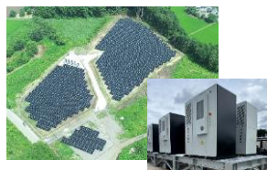
太陽光発電（蓄電池併設型） （栃木県鹿沼市・FIT）
