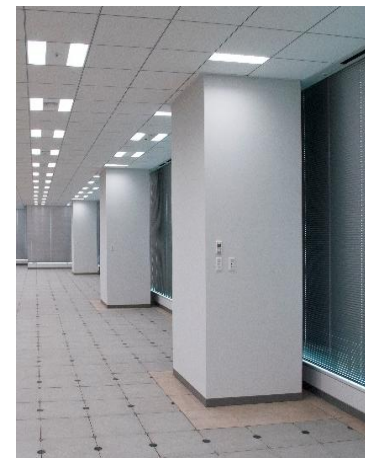
柱の耐火被覆 (オフィス)
