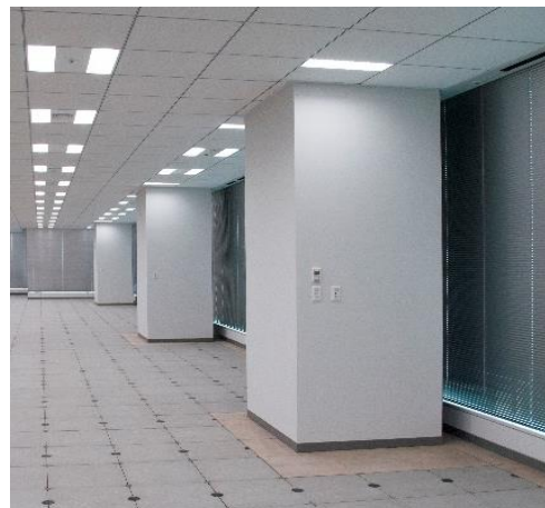
柱の耐火被覆（オフィス）
