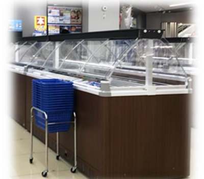
アクリルの扉を設置した 冷凍ショーケース
