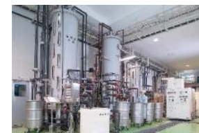
イオン交換樹脂再生設備
