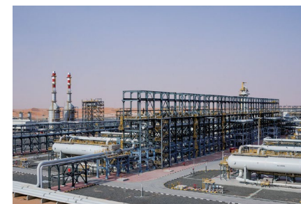
アブダビ陸上鉱区 原油処理施設
