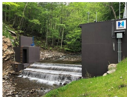
小水力発電：群馬県川場村(FIT)
