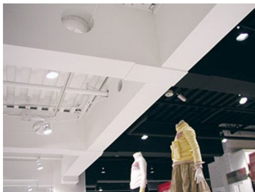
はりの耐火被覆（商業施設）
