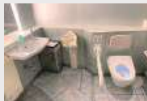
・節水型トイレの設置
