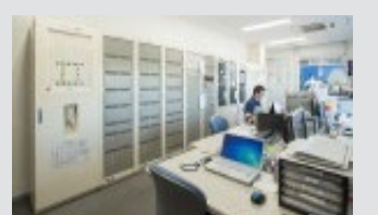
24時間365日稼働の 防災センター
