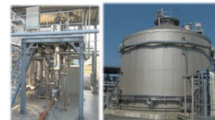
B-DASHプロジェクト (汚泥可溶化装置と無動力消化槽)
