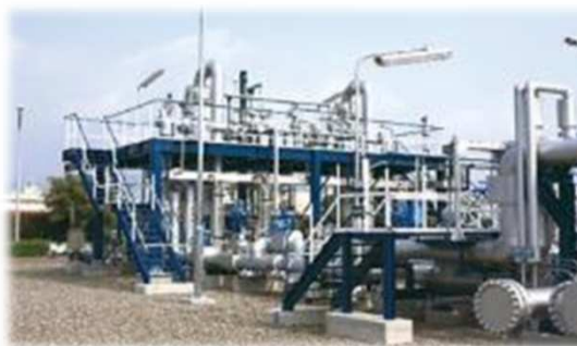
■ 液ガス熱調設備
