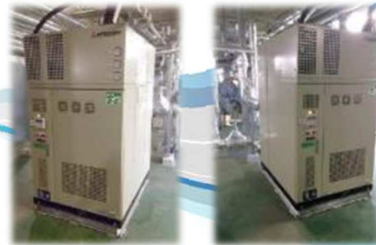
■ 消化槽の熱回収（ヒートポンプ）
