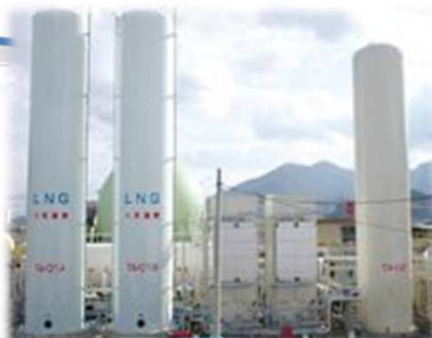
■ LNG (液化天然ガス) サテライト設備
