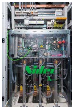
電力変換システム
