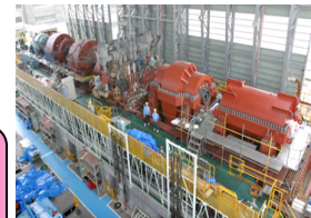
【エチレンプラント用コンプレッサ】
